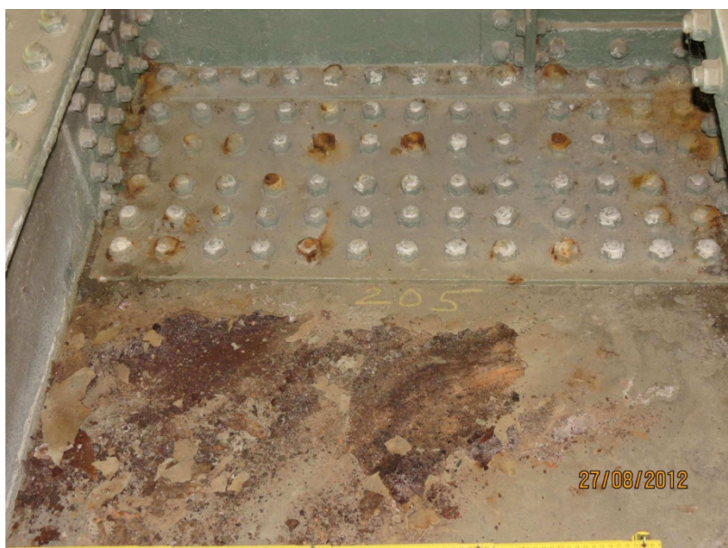
Abb. 3: Lokale Korrosion mit „Blattrostbildung bis zu einer Stärke von ca. 1,0 cm“
