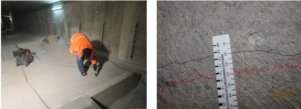
Abb. 4: Absaugen zur qualifizierten Rissaufnahme, A9 Donaubrücke Ingolstadt
