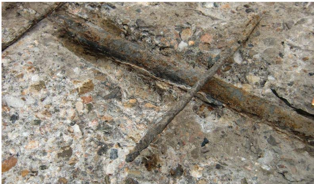
Bild 4: Korrosion an schlaffer Bewehrung und Spannbewehrung mit weitgehend wegkorrodiertem Hüllrohr
