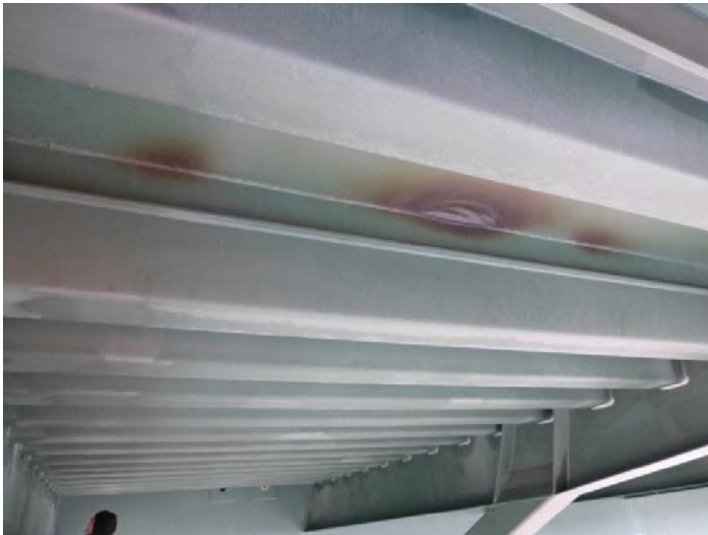
Abb. 12: verschmorter Korrosionsschutz an der orthotropen Fahrbahnplatte
