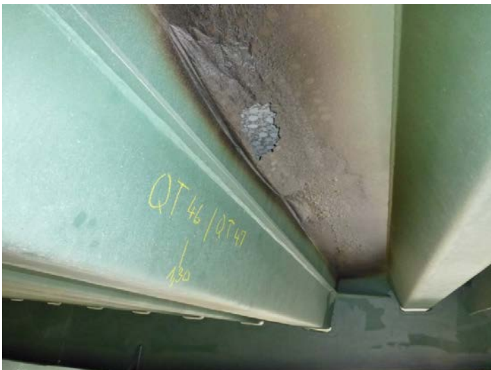
Abb. 13: verschmorter Korrosionsschutz an der orthotropen Fahrbahnplatte
