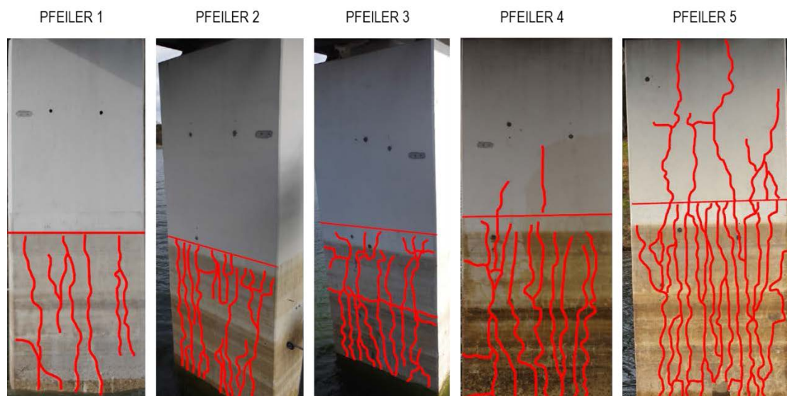
Abbildung 9: zum Vergleich sichtbare Rissbildung an den Pfeilern 1 bis 5
