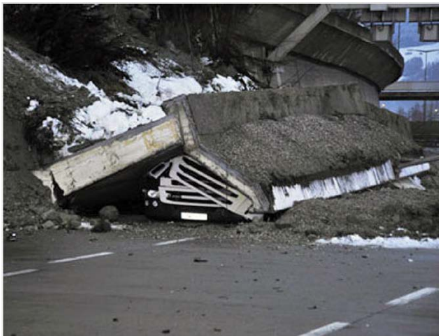
Bild 1: Eingestürzte Stützwand Brennerautobahn 1
